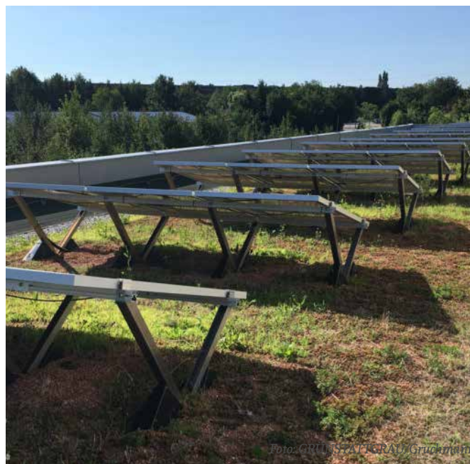
Kombination Photovoltaik mit Dachbegrünung.
